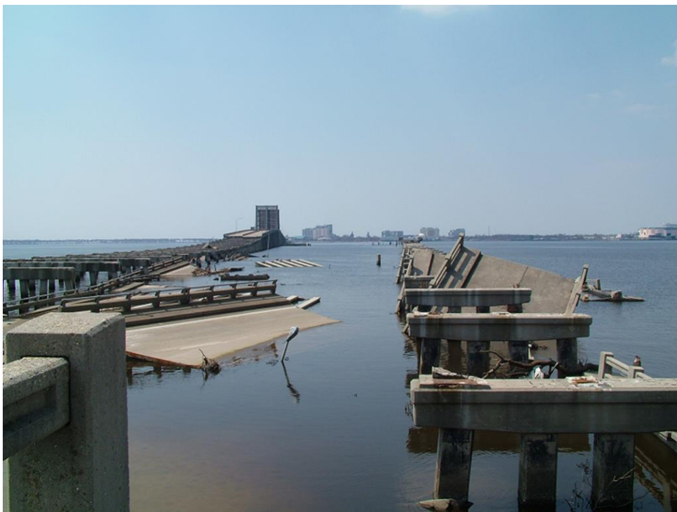
Slika 15 Porušitev mostu zaradi orkana
