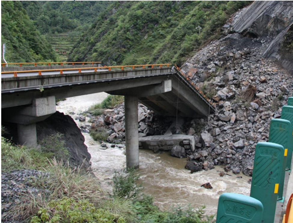
Slika 14 Porušitev mostu zaradi zemeljskega plazu na Kitajskem
