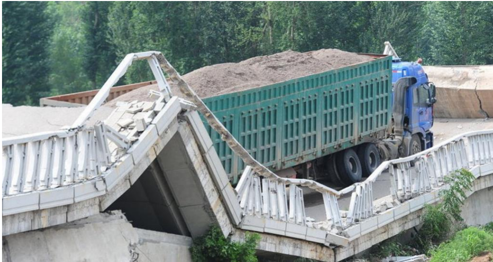
Slika 16 Porušitev mostu zaradi prevelike obremenitve
