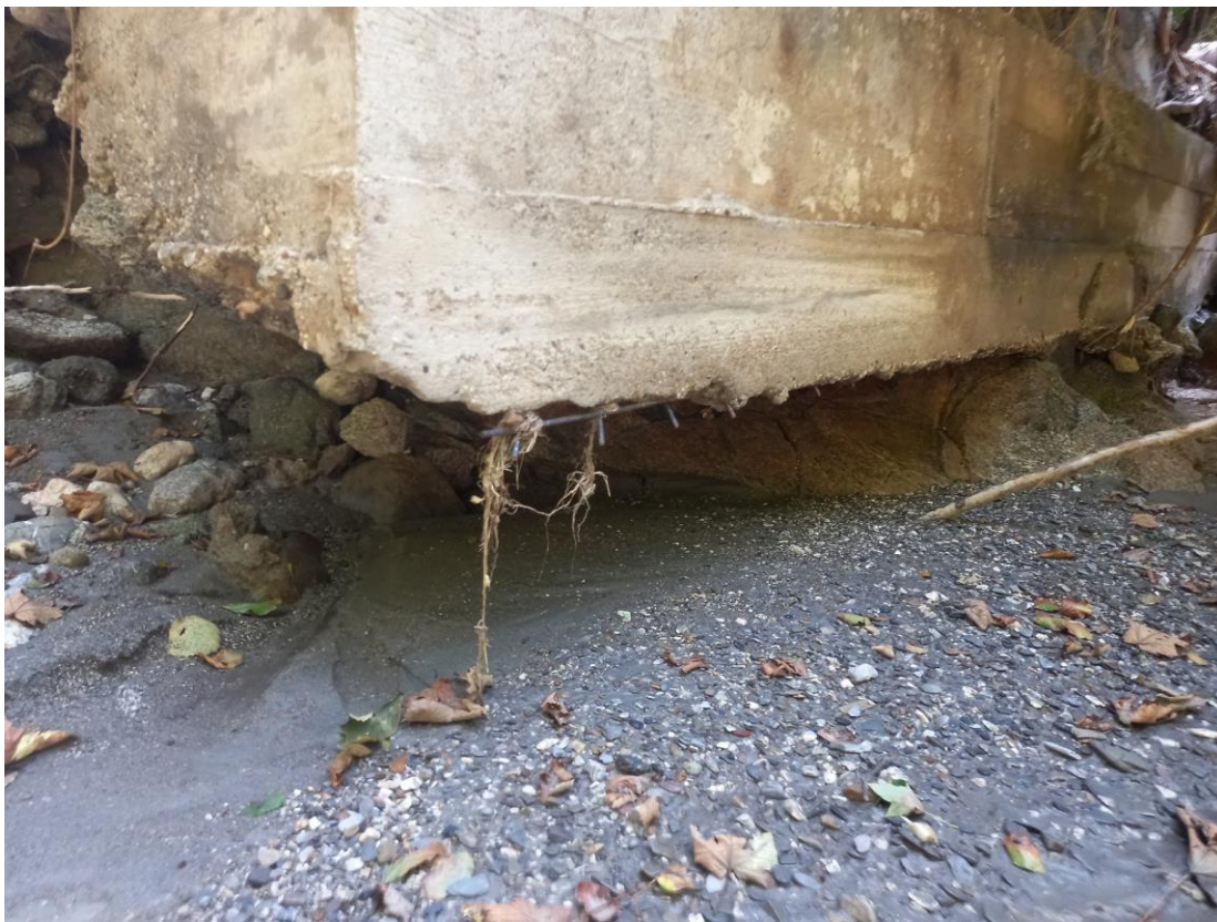
Slika 19 Eroziija pod temeljem opornika v Črni na Koroškem
